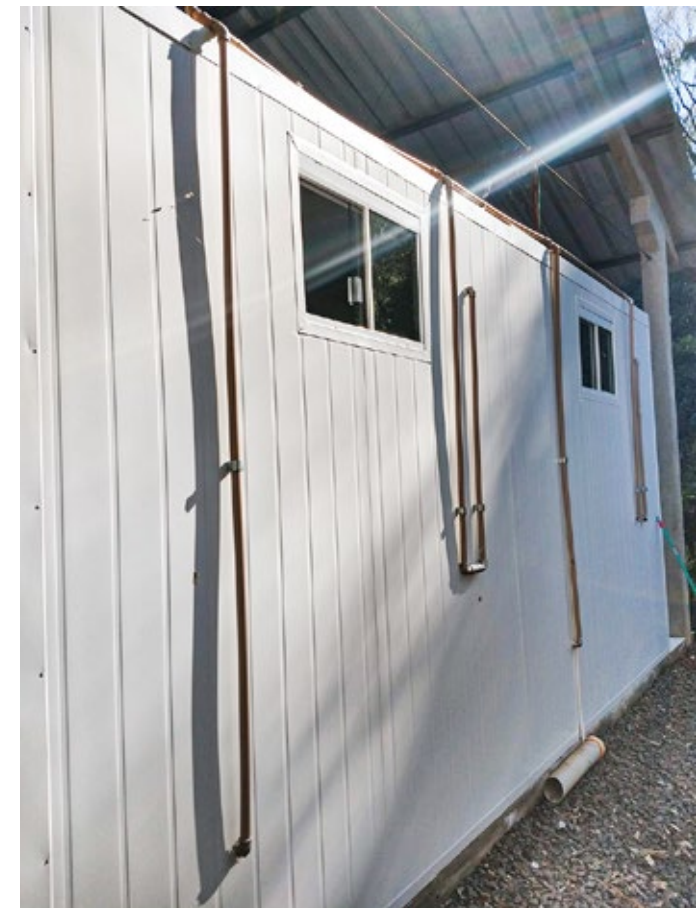
Figura 16 – Instalações hidráulicas aparente.
