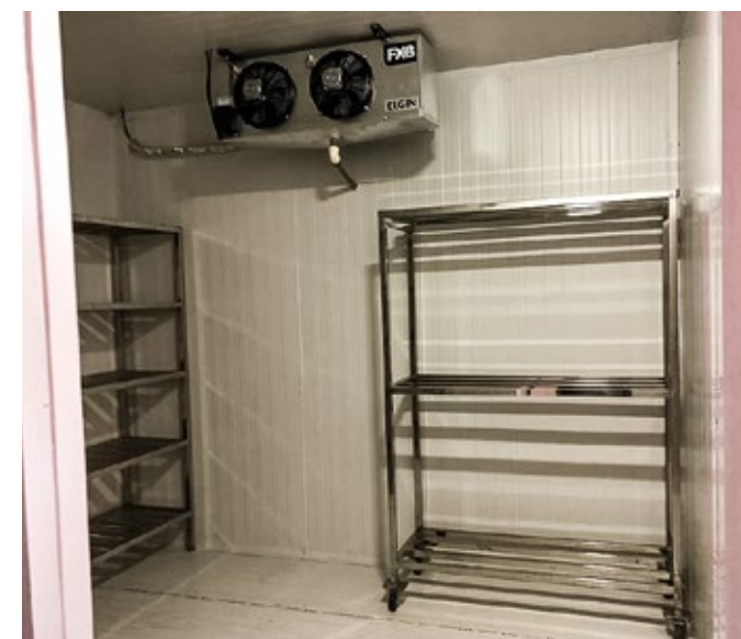
Figura 11 – Câmara de armazenamento refrigerada.
